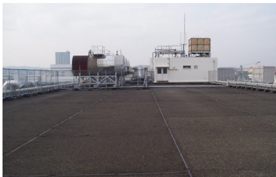
緑化されていない建物の屋上 下の部屋は夏場高温となる
