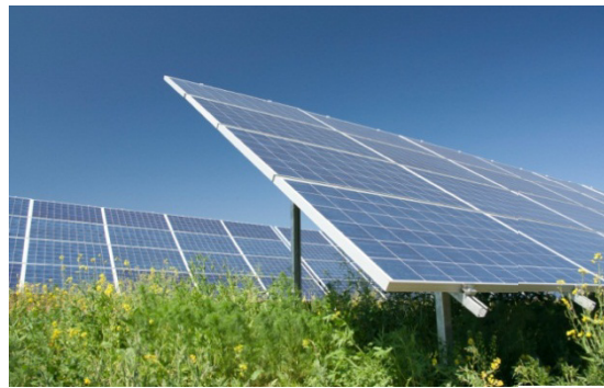
雑草が繁茂しているメガソーラー施設
